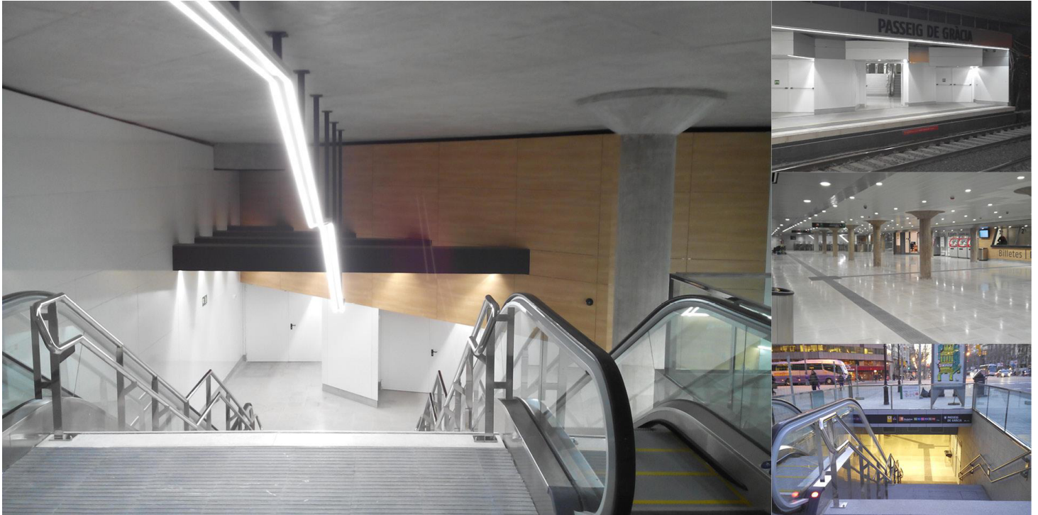
forjados de vestíbulo losa armada y bóveda de hormigón en masa en andenes
